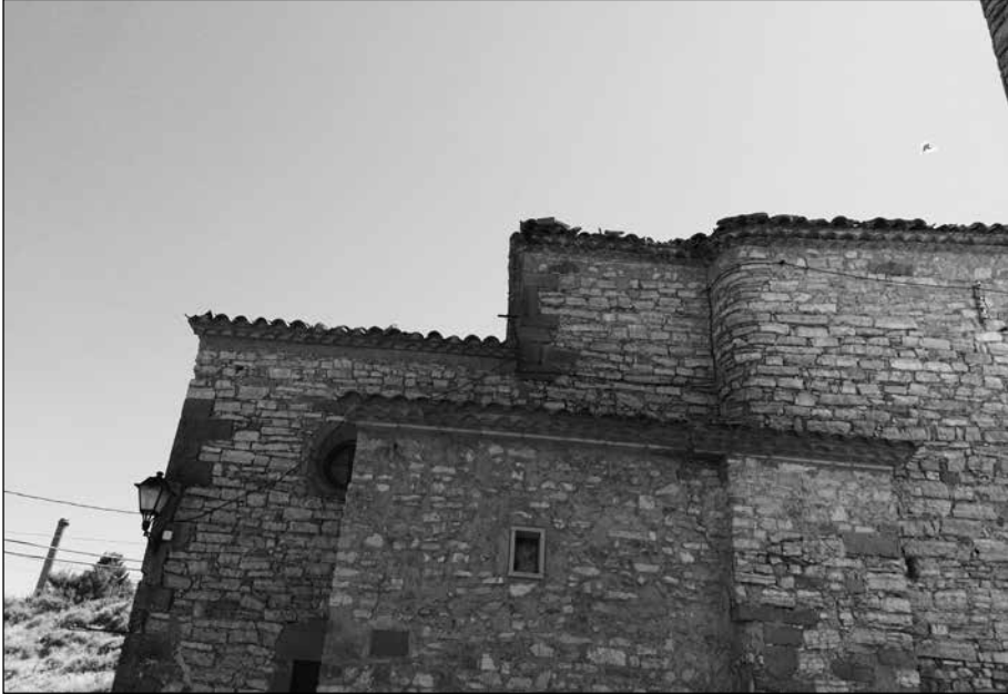
El mal estat de la teulada.
